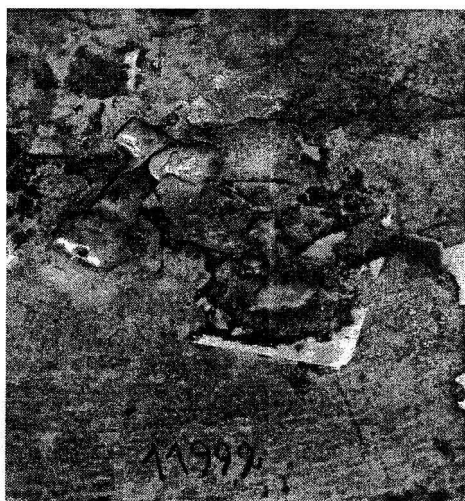
Fig. 7 Detaliu cu punctele de coroziune cu clorură de cupru.
